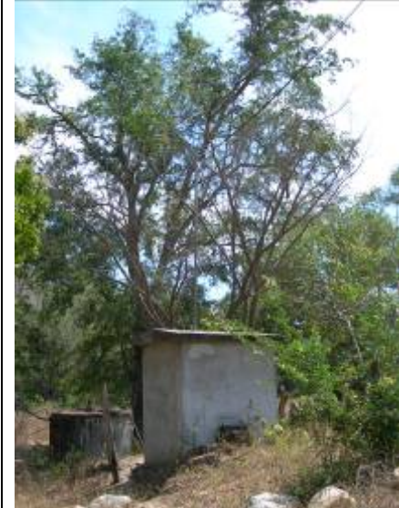
Pozo al fondo e instalaciones de la bomba de agua en Zimatán, ubicadas en la parte baja del pueblo.
